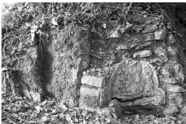
8. Punto di presa alla quota di sfioro del bacino (foto Placidi).
